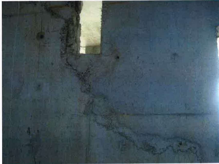
Şekil 2.4. Soğuk derz oluşan betonlar
