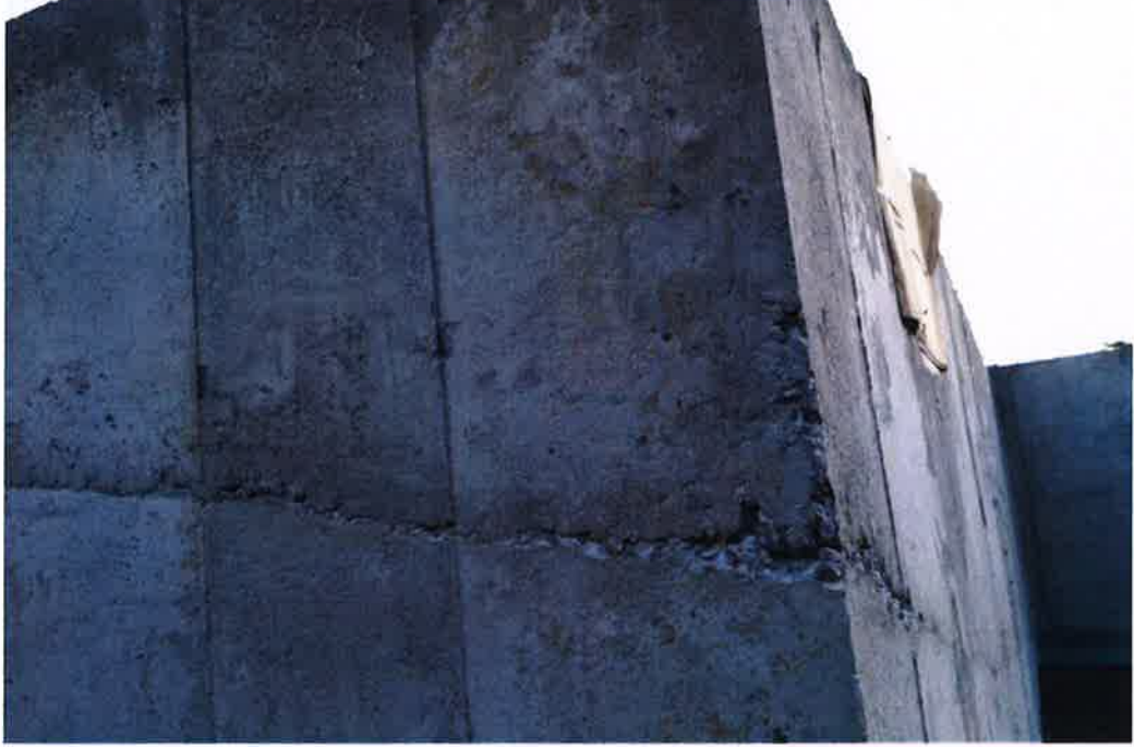
Şekil 2.1. Farklı zamanlarda dökülerek ek yerleri oluşturulan betonarme yapılarda oluşan soğuk derz betonların örnekleri[32]
