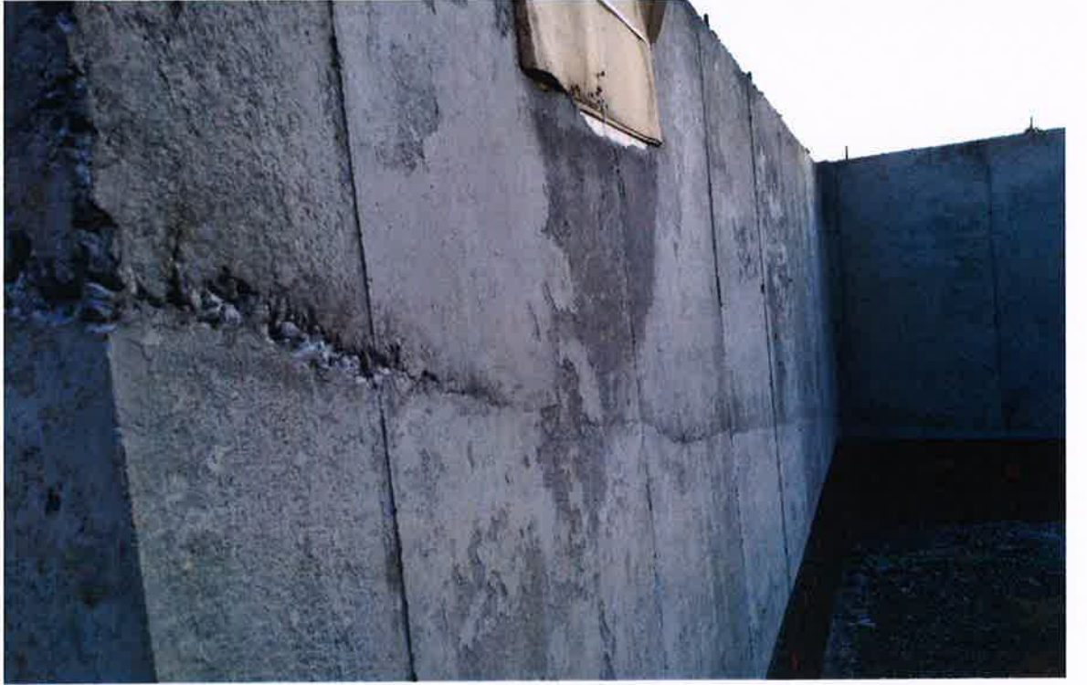
Şekil 2.2. Farklı zamanlarda dökülerek ek yerleri oluşturulan betonarme yapılarda oluşan soğuk derz betonların örnekleri[33]
