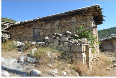
Yapının yıkılan bölümü
