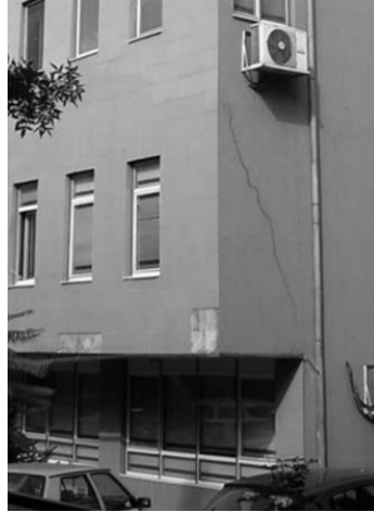
Şekil 16. Sehime bağlı konsol üzerinde duvar çatlak hasarı
