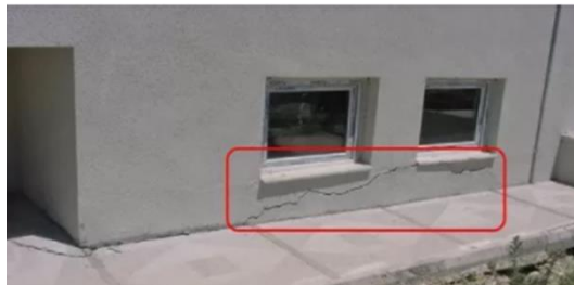
Şekil 15. Zemin kat duvar hasarı
