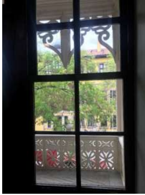
Şekil 33: Mimarlar Odası 1.kat kuzey cephede bulunan balkon korkuluk ve zemin kaplaması
