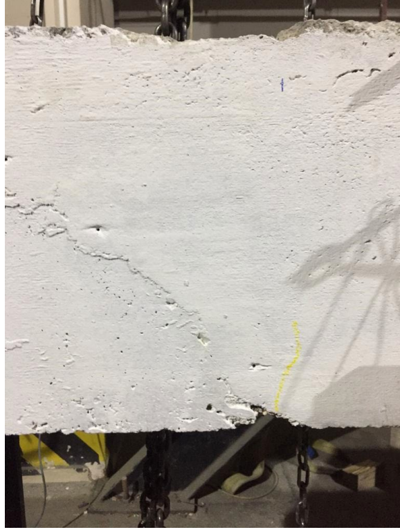
Şekil 30. CJ45R kirişi soğuk derz düzlemi başlangıcında meydana gelen çatlak
