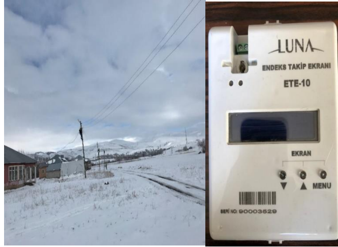
Şekil 4. Direk üstü PLC sayaç montajı ve endeks takip ekranı.
